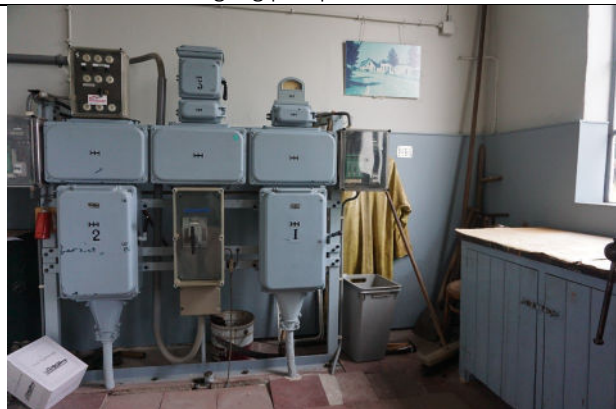
Schakelkasten tegen noordoostelijke wand
