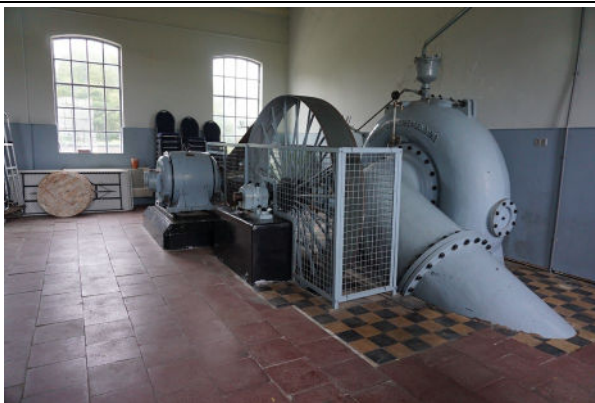
Een van de twee pompen in het interieur
