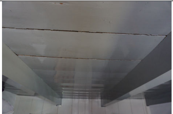
Plafond in voormalige woonhuis
